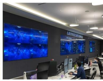
腾讯数据中心弹性高压直流项目
